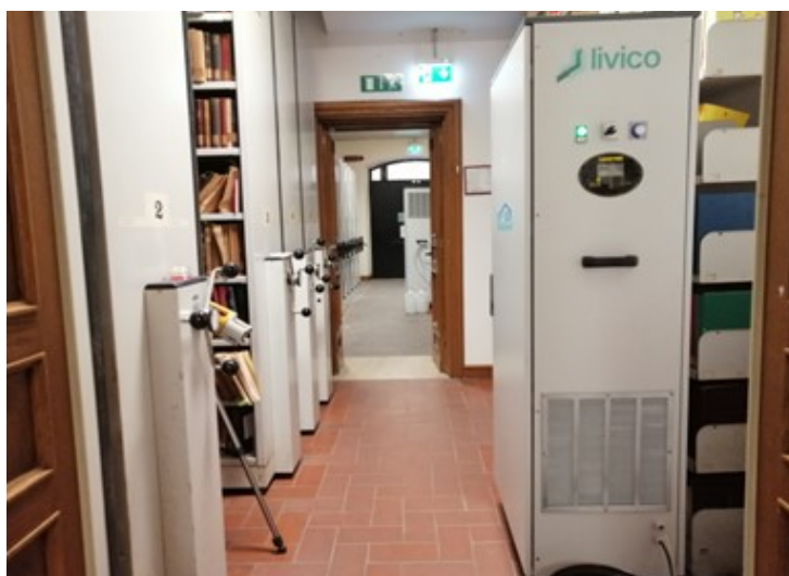
Fig. 14: Dispositivo stand alone per il trattamento dell'aria in un deposito di biblioteca. Foto: Matteo Montanari.
